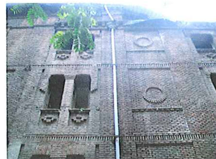
Canalones rotos o desaparecidos y vegetación parásita en los extremos oeste y norte de la torre trasera de escaleras
