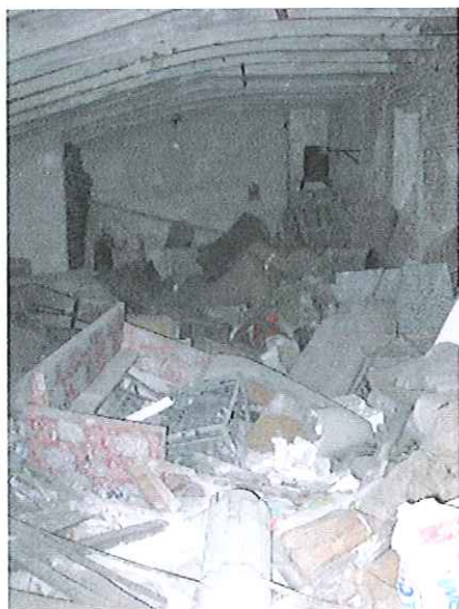
Acumulación de escombros bajo la grada inferior
