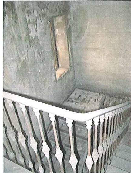
Afección por humedades de los muros de la escalera trasera
