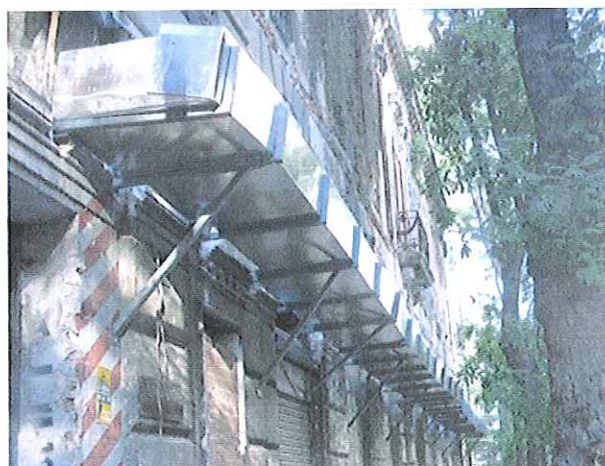
La agresiva y endeble protección instalada por la propiedad
