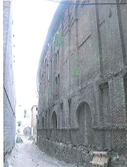
Vista general de la cara oeste con vegetación parásita
