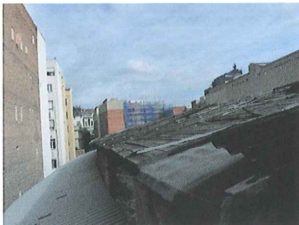
Placas de zinc desaparecidas
