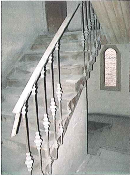
Balaustres desaparecidos en barandilla de escalera principal
