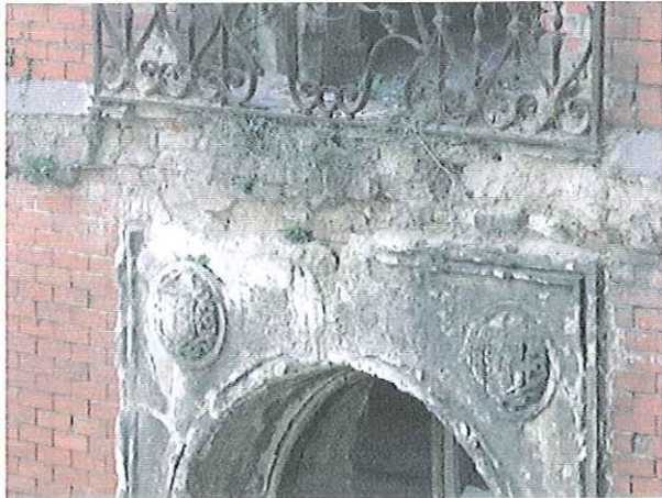
Desprendimiento de molduras de impostas
