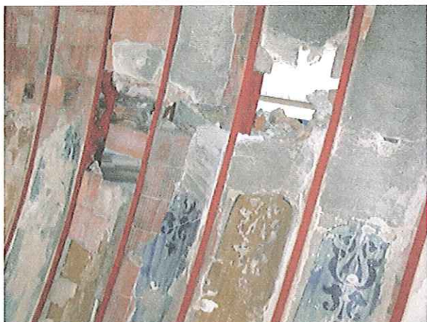
Estado de los revoltones decorados del forjado de tercera planta
