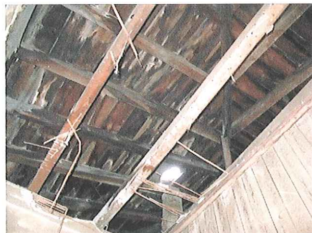
Cubierta del torreón con el cielorraso desprendido
