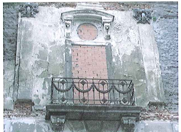
Detalle de los desperfectos causados por el anterior andamioje
