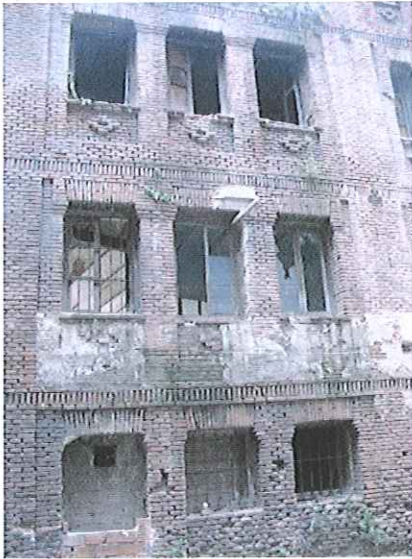
Estado de la fábrica de ladrillo en la cara norte
