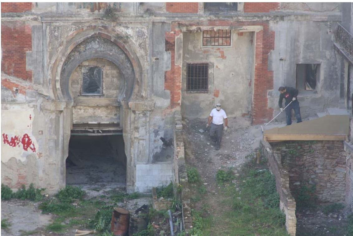
Protección?.. de la escalera con tablero aglomerado.. Protecciones de huecos con plásticos, de dudosa efectividad.
