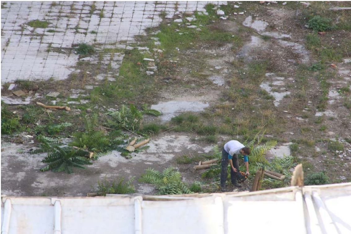
Operario troceando troncos de Ailanthus en la cancha, con motosierra, y sin guantes ni gafas protectoras.
