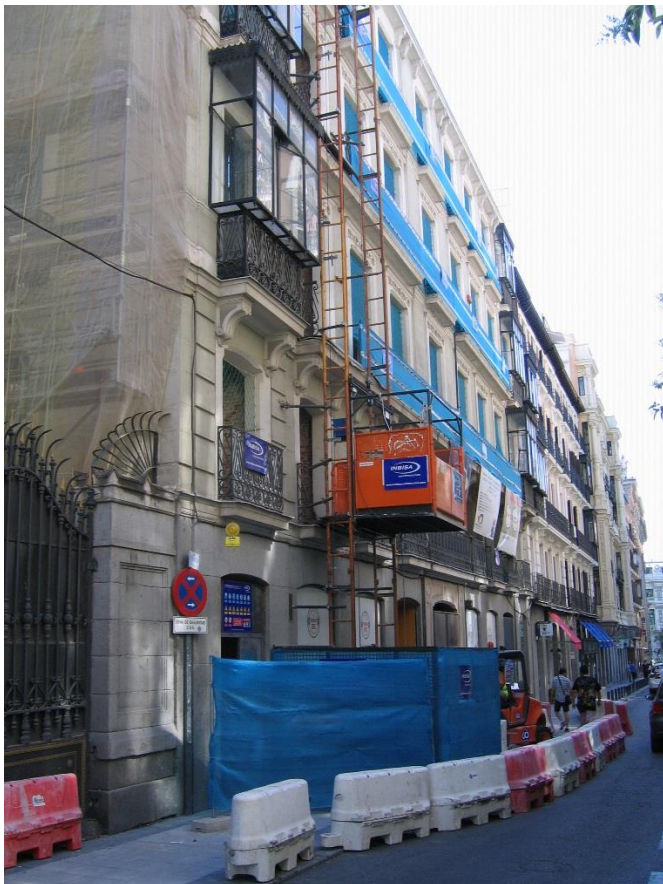
Protección para un ascensor provisional en la rehabilitación del inmueble de la C/ Barquillo 12. La acera permanece cortada.
