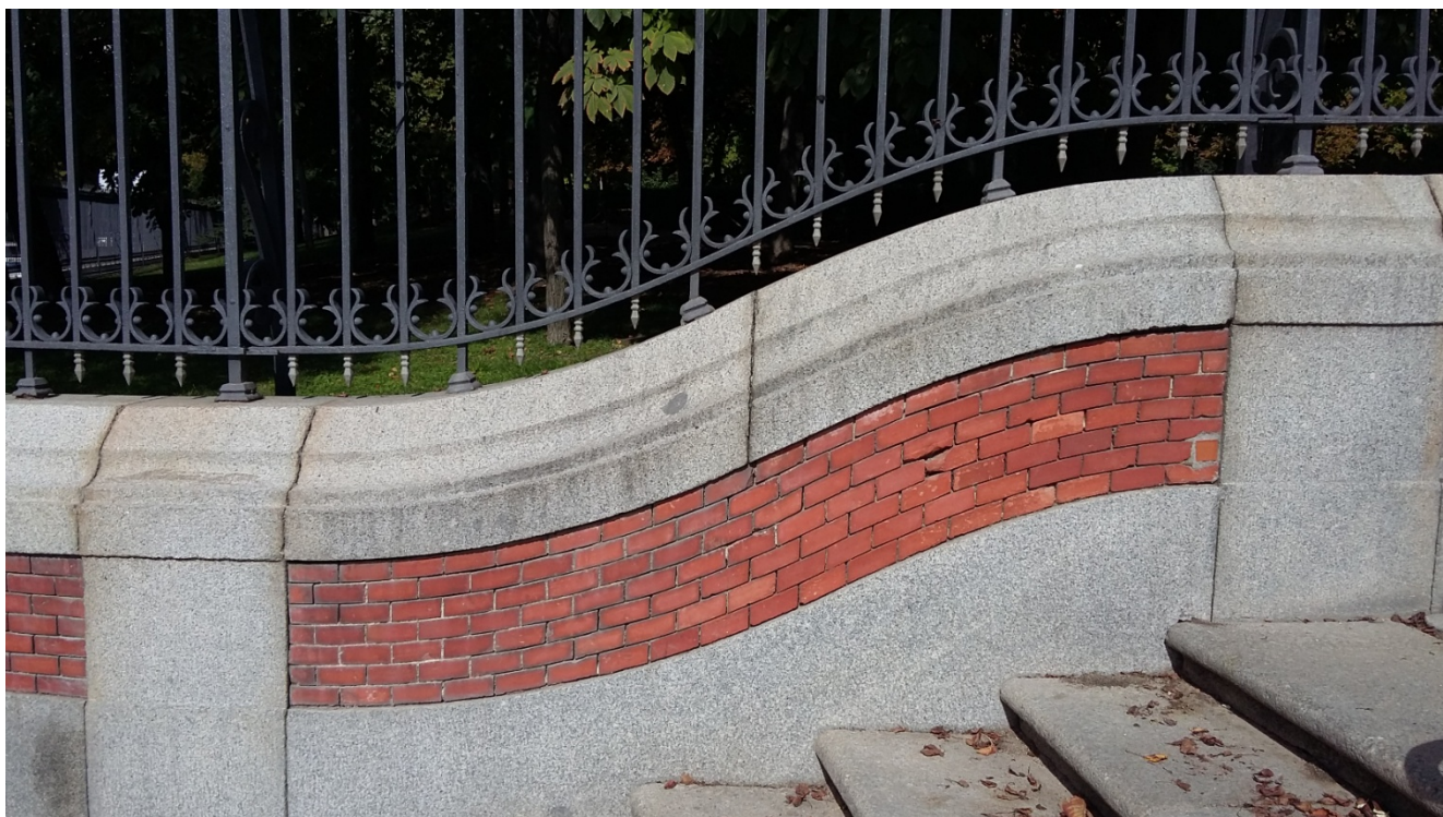
Fig. 72- Detalle del derrame izquierdo de la verja de la Puerta de España del Parque del Retiro, donde puede verse como los ladrillos se modelan uno a uno, con las juntas siempre verticales, para adaptarse a la línea sinuosa del trazado. Foto VPAT.
